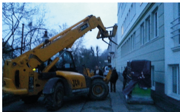
Rys. 13. Instalacja komory na podnośniku
