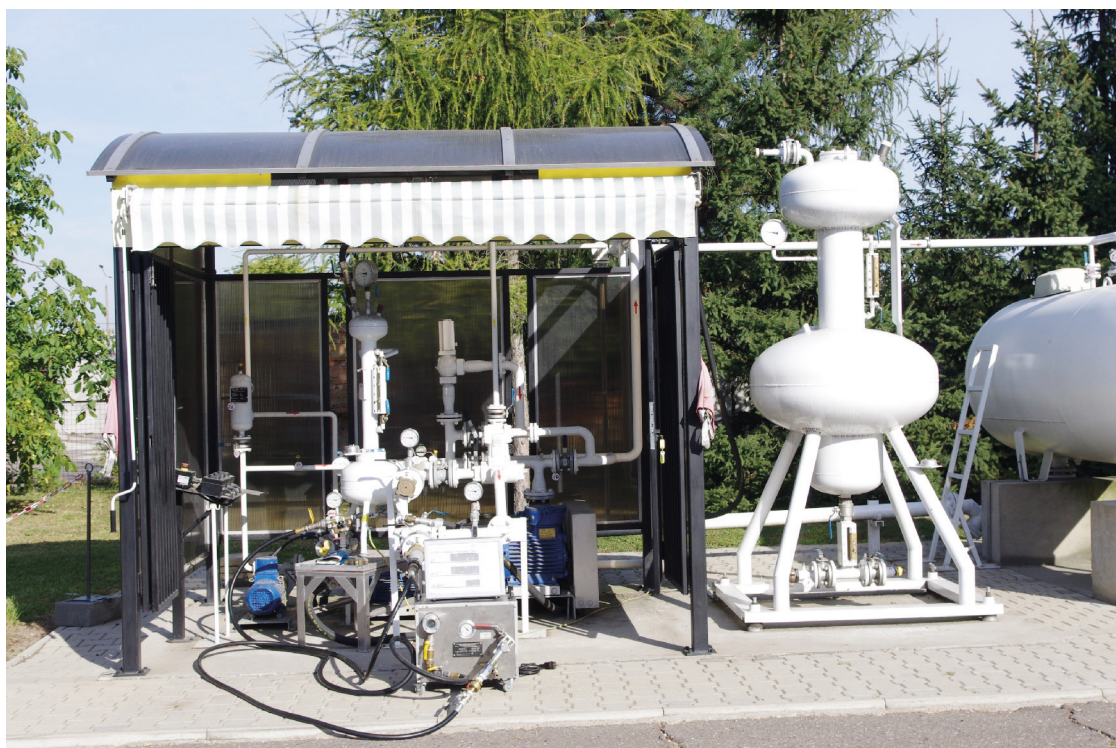
Rys. 1. Stanowisko do badań stacjonarnych i przewoźnych instalacji pomiarowych do gazu ciekłego propan-butan (LPG)
