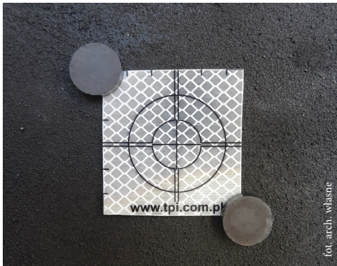
Rys. 6. Tarcza geodezyjna umieszczona na wewnętrznej ścianie zbiornika
