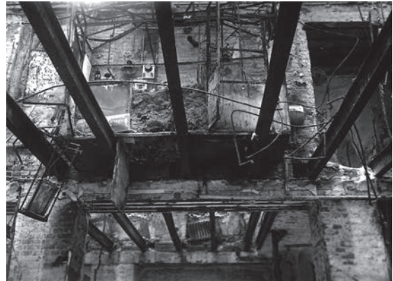
Zdewastowane przez niemieckie wojska wnętrze jednej z części siedziby GUM, tzw. budynku G fot. arch. Jerzego Janiszka
