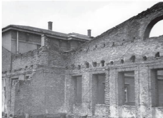
Wypalone stropy w budynku GUM fot. arch. Jerzego Janiszka
