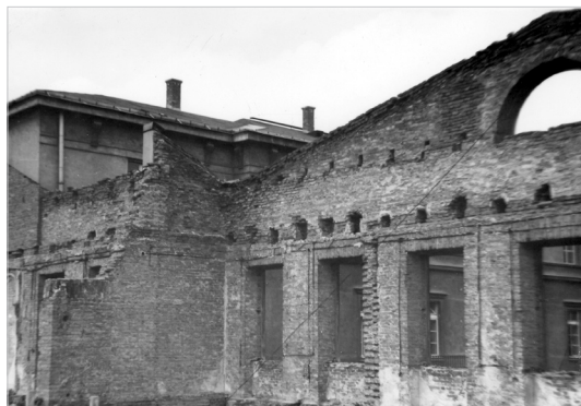
Ilustr. 2. Wypalone stropy w budynku GUM
