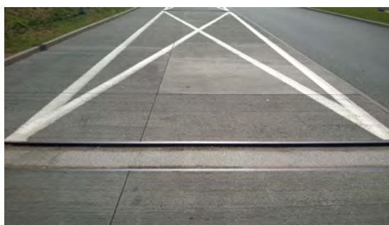
Rys. 5. Stanowisko do wyznaczania masy pojazdu wagami, podlegającymi prawnej kontroli metrologicznej, na autostradzie A2 – kierunek Świecko
